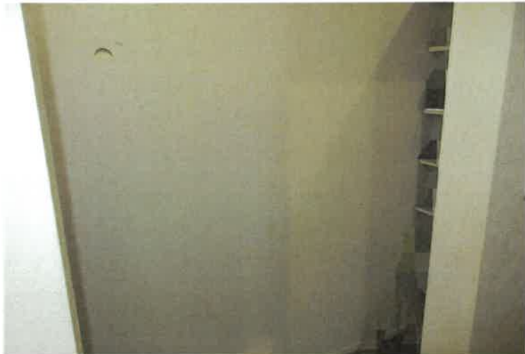
写真5 1階玄関横収納（凹みあり）
