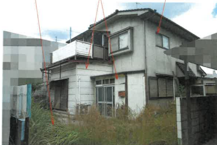
写真1 物件1 土地 未登記増築部分 物件2 建物
