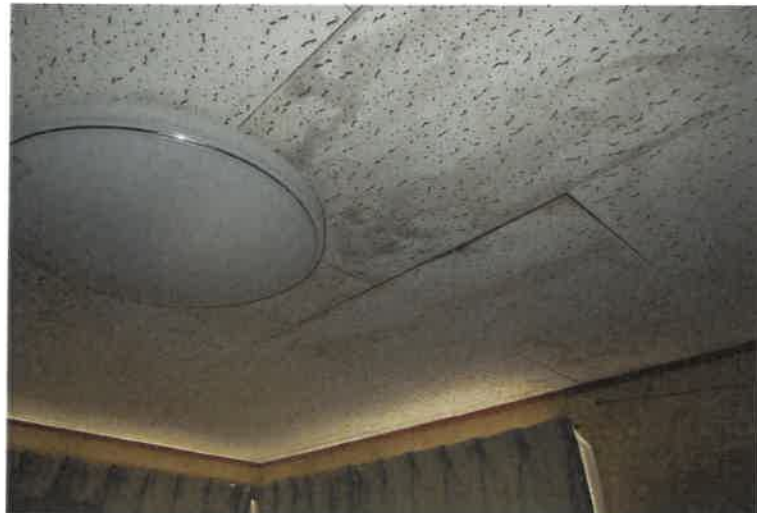
写真 1 6 2 階洋室天井部分（雨シミ）
