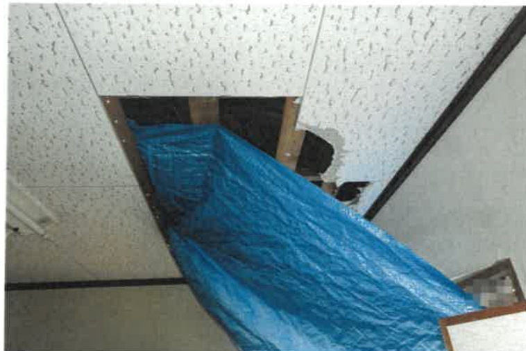
写真 4 0 2 階洋室①天井の雨漏りの状況
