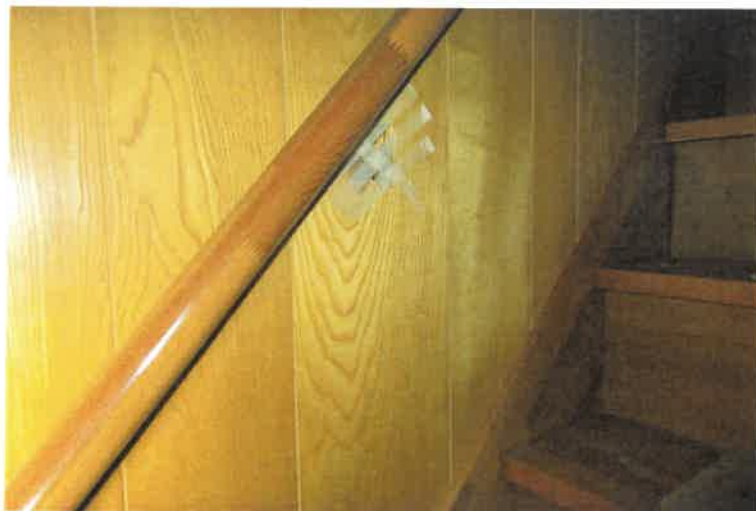
写真 2 8 物件 4 建物・1 階階段部分（穴あき）
