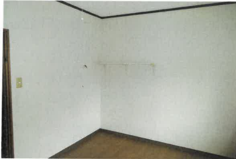
写真3 1 物件4建物・2階北側洋室（穴あき）
