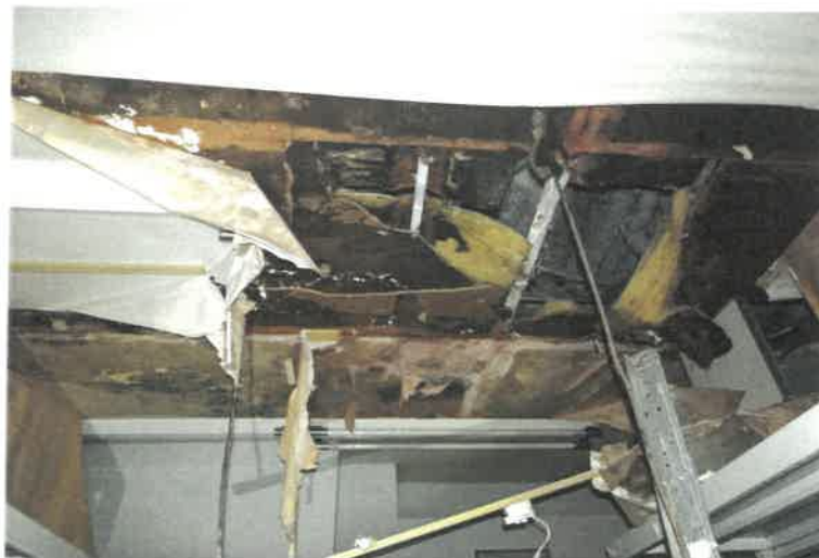
写真 1 0 1 階南東付近の天井の状況
