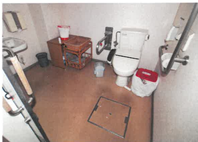
写真 1 5 （1 階西側トイレ）
