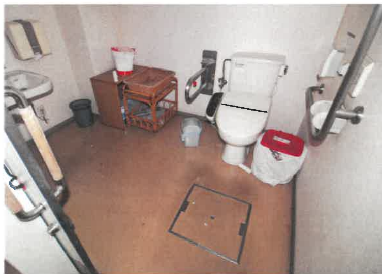
写真15 (1階西側トイレ)
