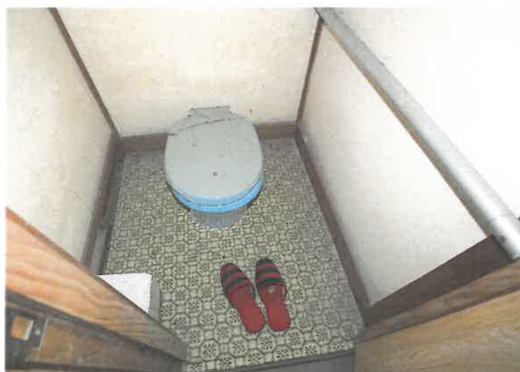
写真18 (物件3符号1附属建物トイレ)
