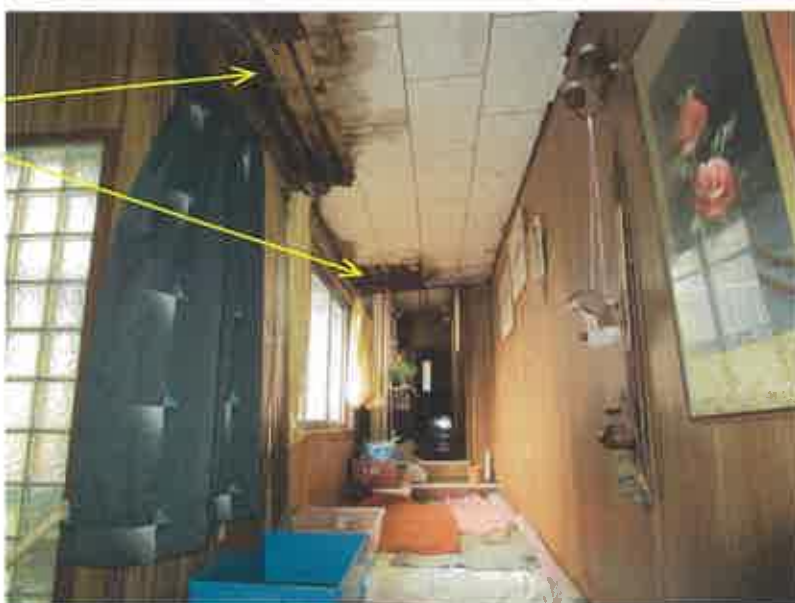
⑨ 雨漏り 物件 4 2 階
