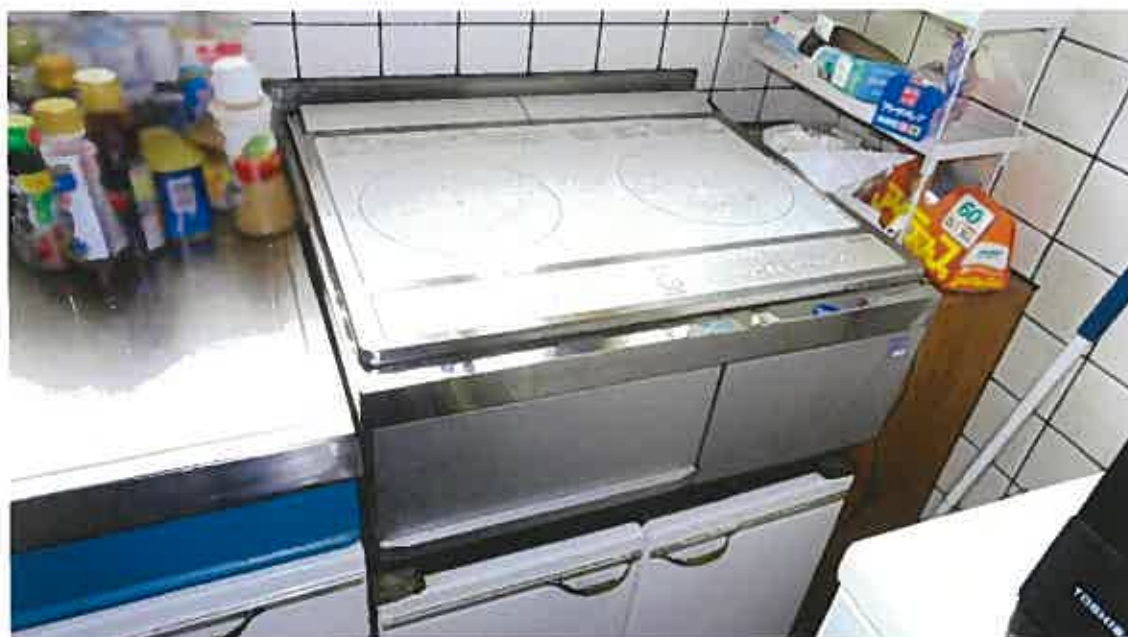
写真18 IHヒーター(リース)
