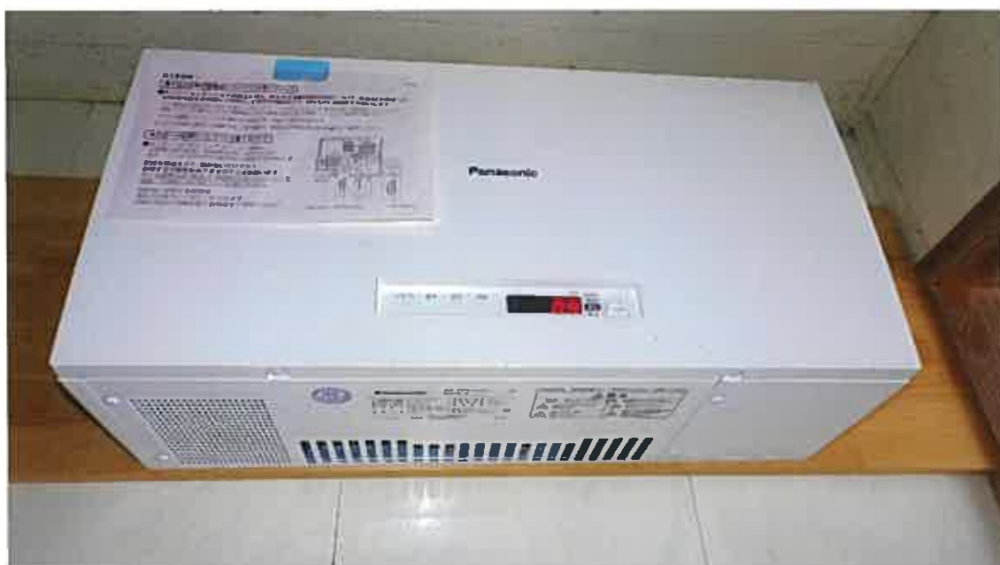
写真15 太陽光発電パネル のコントローラー
