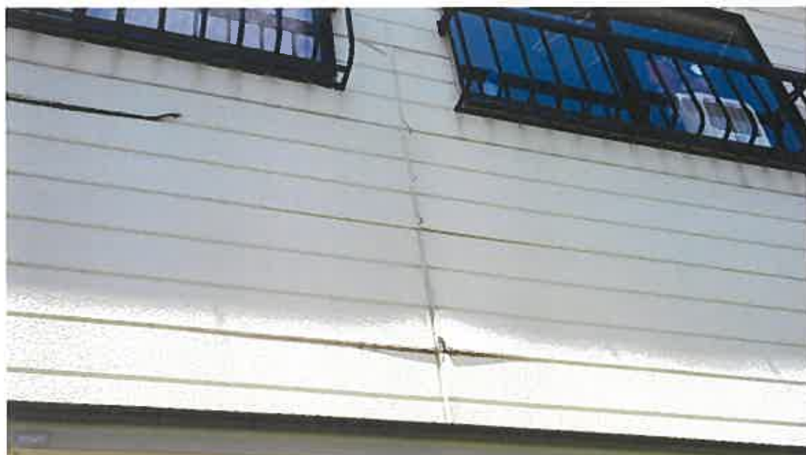
外壁のひび割れ等
