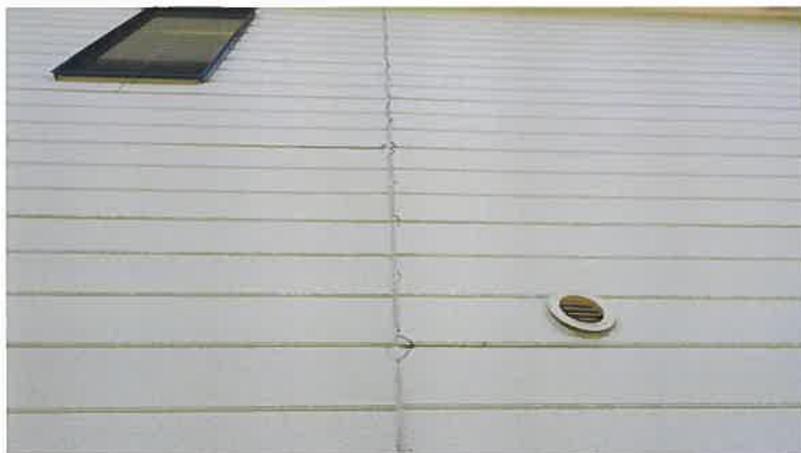
外壁のひび割れ等
