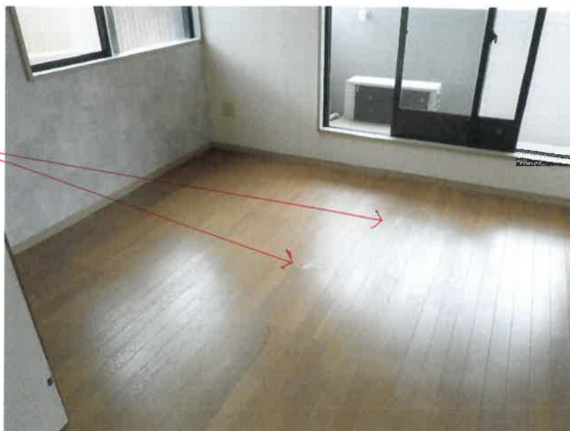
床板の表面の剥がれ
