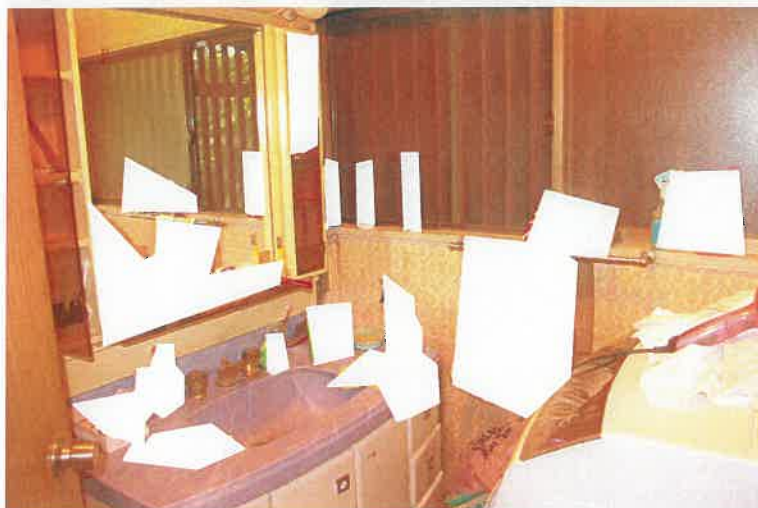
洗面所 (物件 2 建物)
