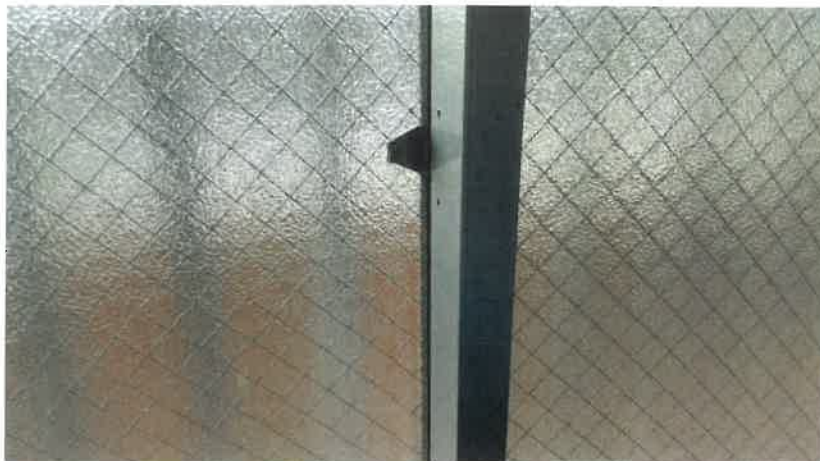
7 洋室1の窓の鍵の破損
