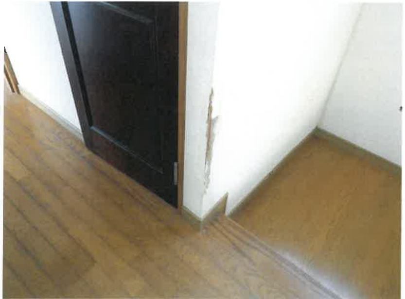
14 3階階段付近の壁の傷み
