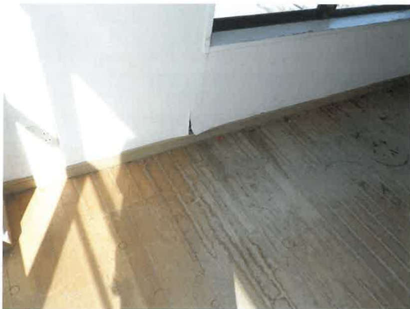
11 同(クロスの剥がれ)
