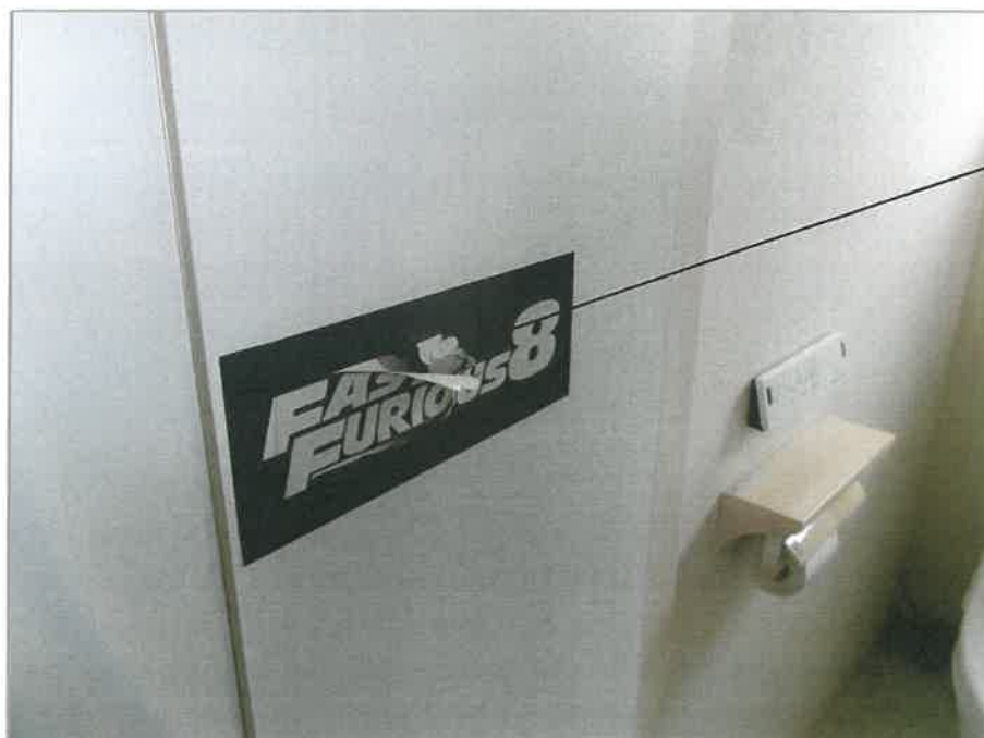
5 室内(2階)の状況 (トイレのドアの破損 状況)
