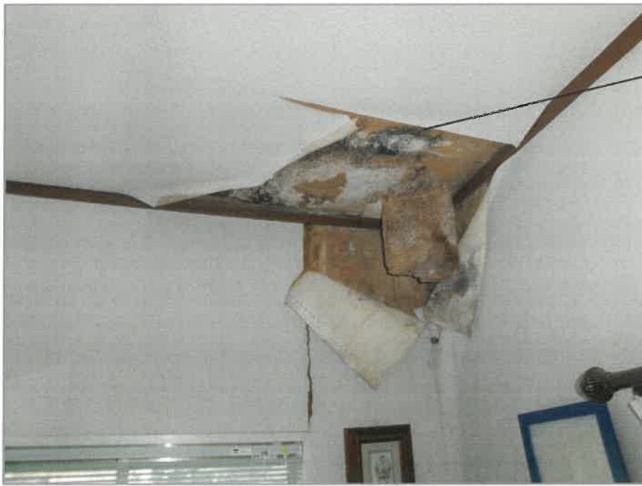
7 室内の状況 (破損状況)
