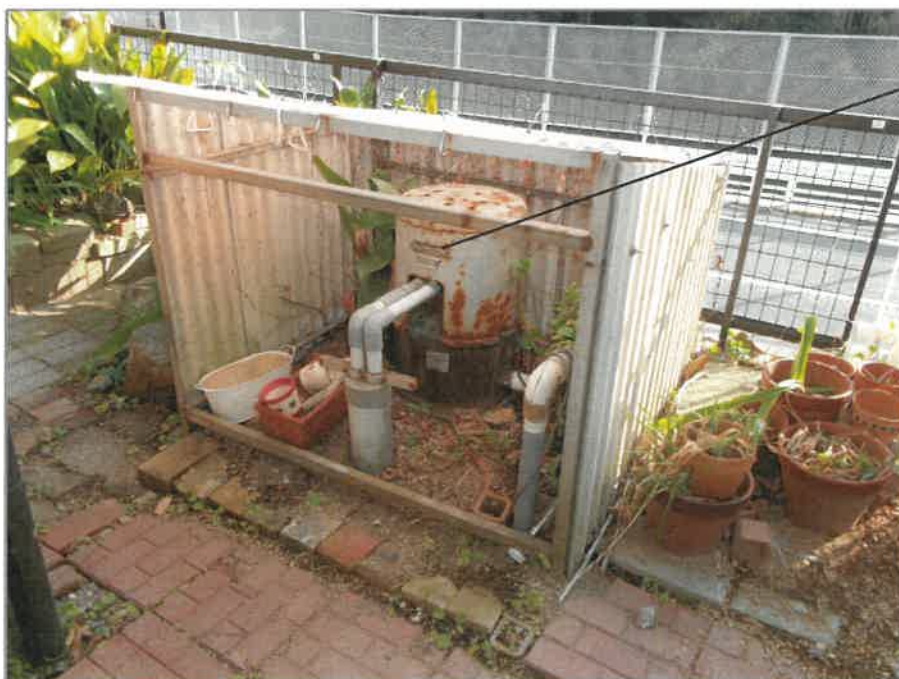
5 井戸・ポンプ
