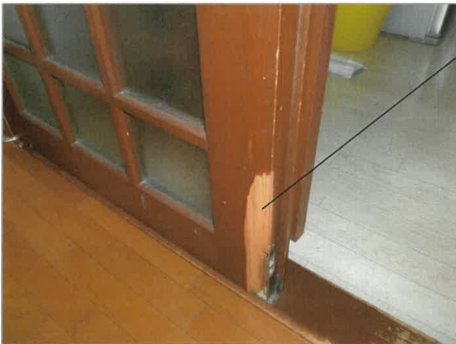
5 室内の状況 (破損状況)
