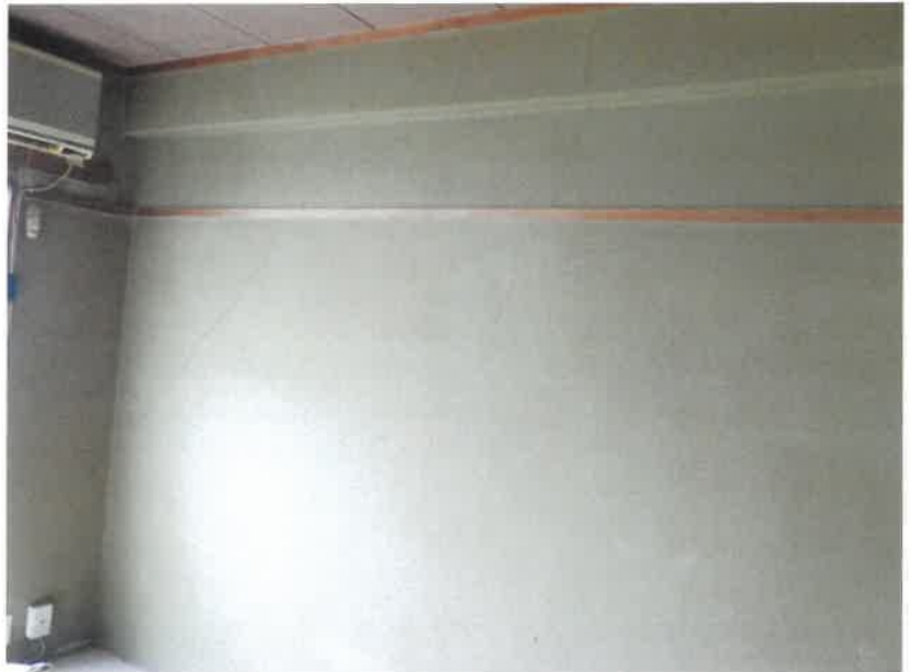
7 和室6畳の壁のひび 割れ等
