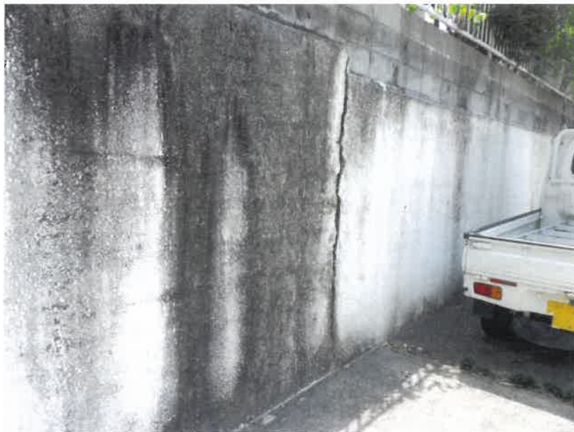
10 隣地の擁壁のひび割れ
