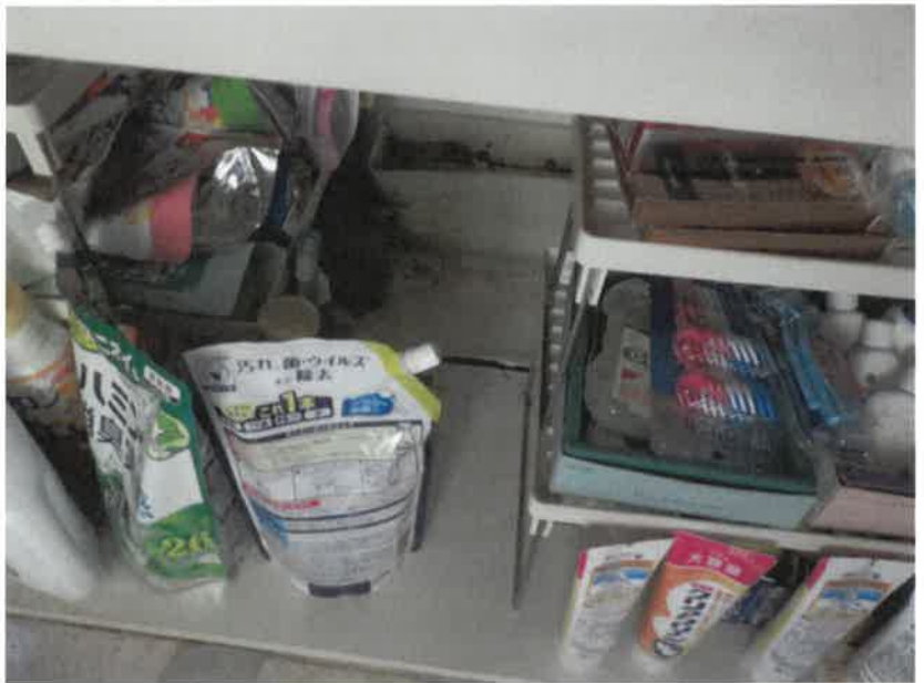
8 洗面所床のひび割れ
