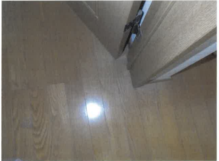
11 2階洋室3のドアが床に当たりこすれた跡
