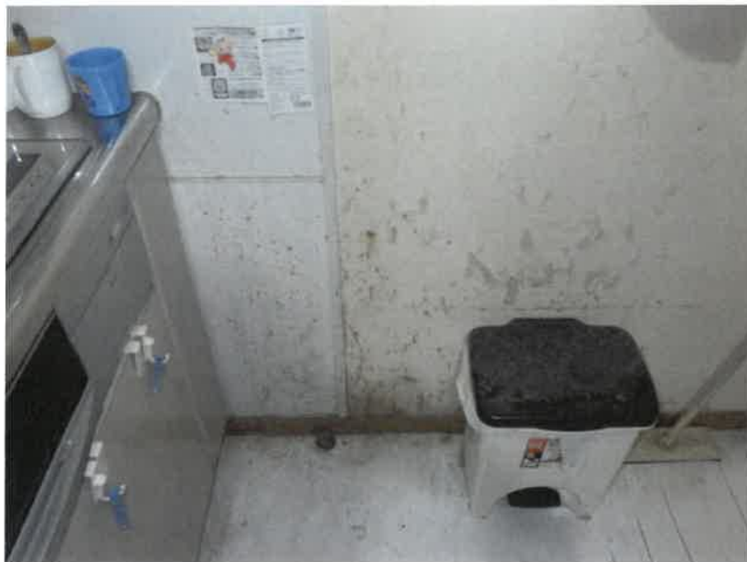
4 キッチンの壁と床の黴と汚れ
