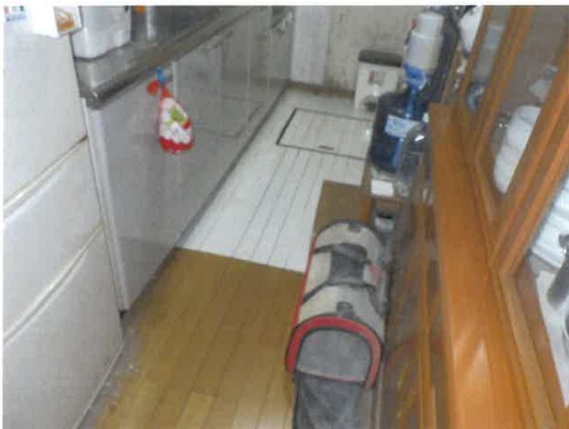
5 キッチンの床の補修跡
