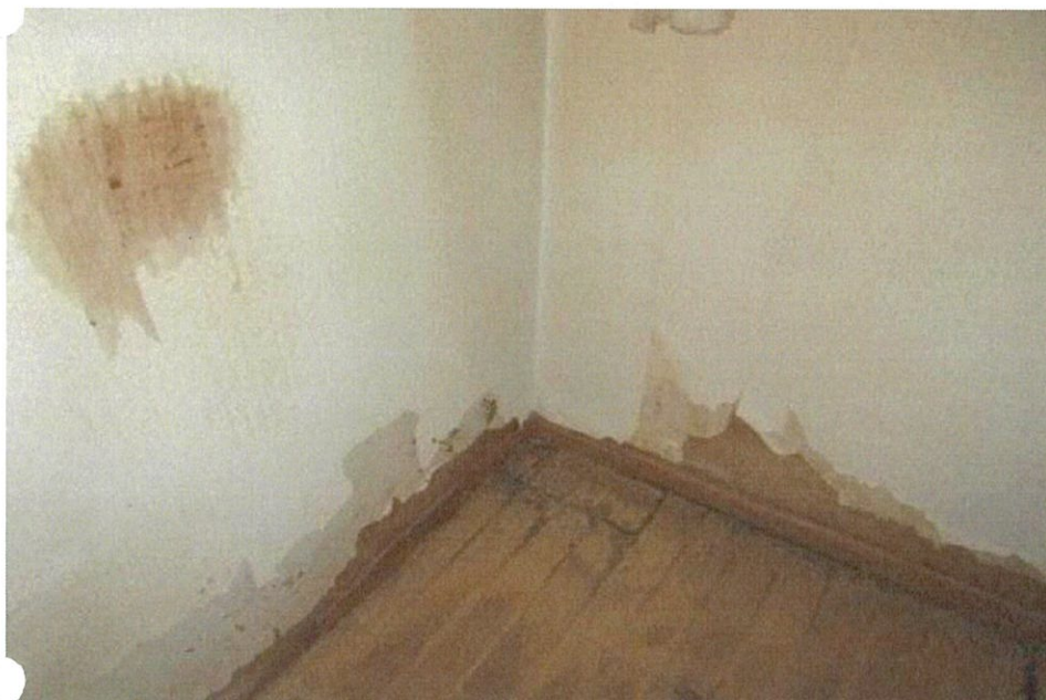
No. 11 損傷状況を撮影
