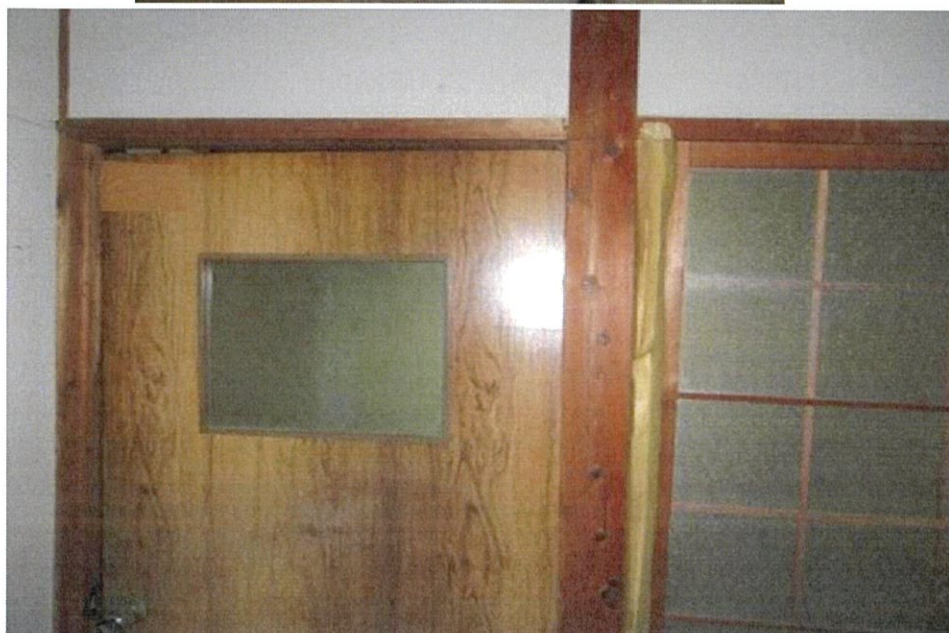
No. 9 建具の傾きを撮影
