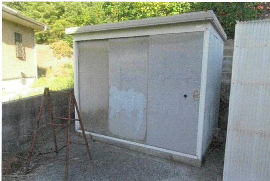
No. 10 スチール製物置を撮影
