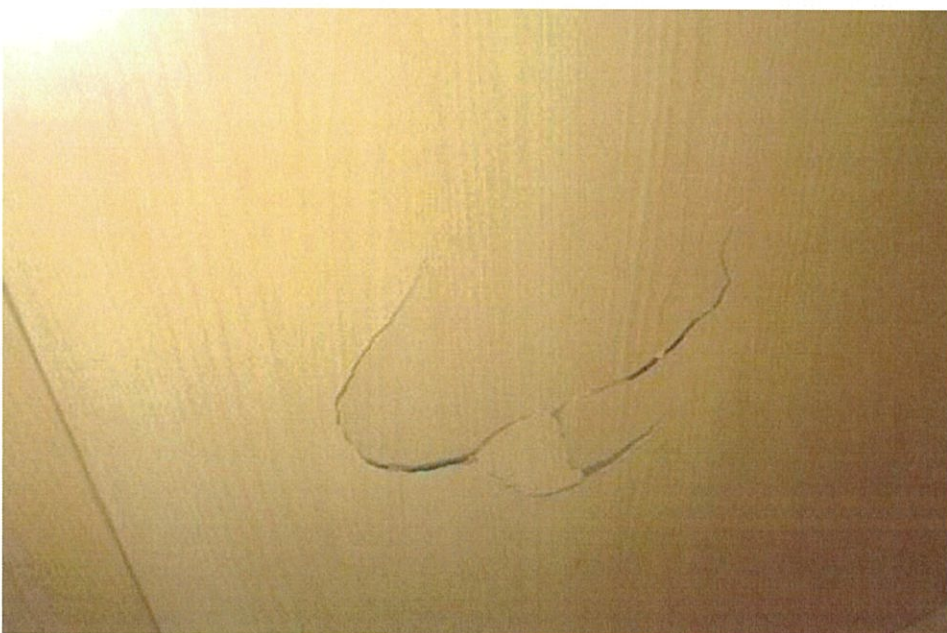
No. 9 ドアの損傷を撮影
