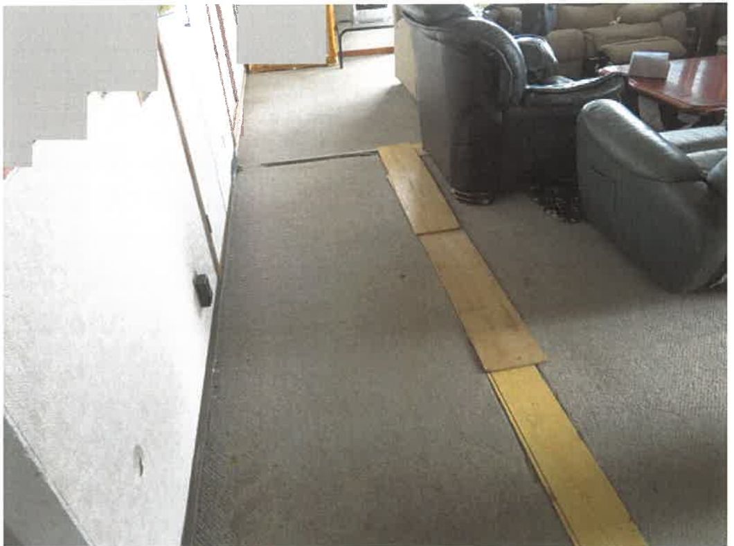
(写真 1 2) …床が板で補正されている
