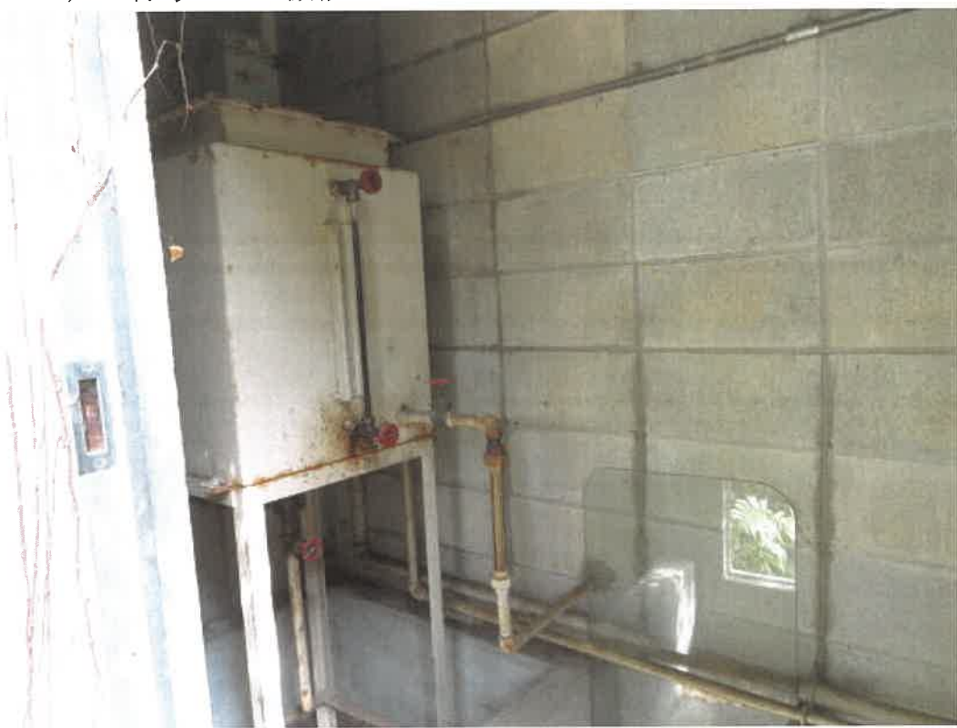
(写真 5 8) …符号 1 1 ・機械室
