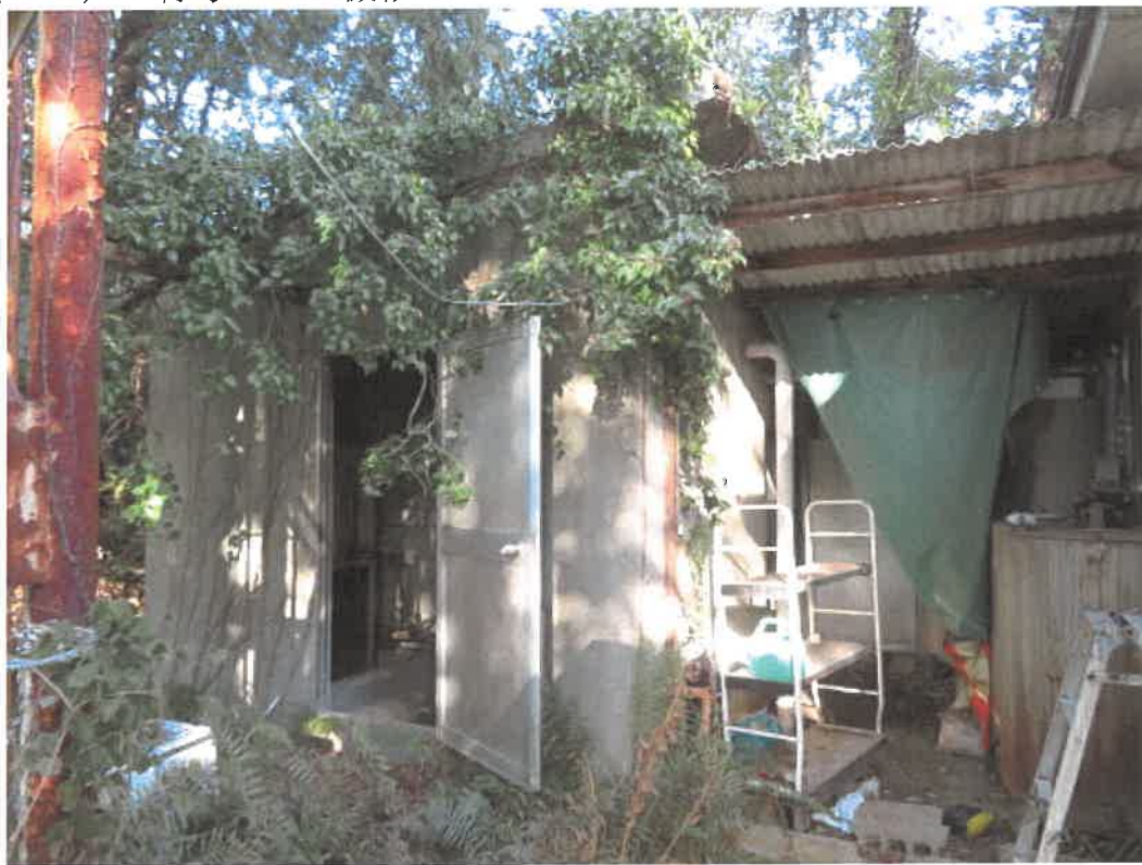
(写真 5 7) …符号 1 1 ・機械室
