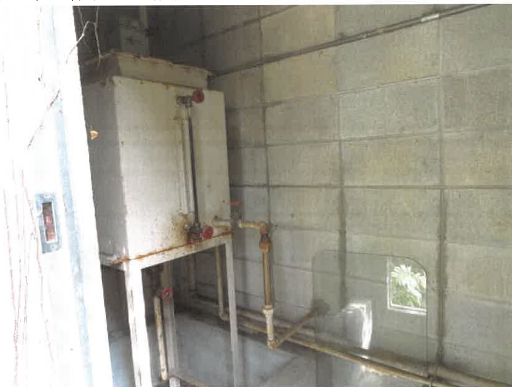
(写真 5 8) …符号 1 1・機械室
