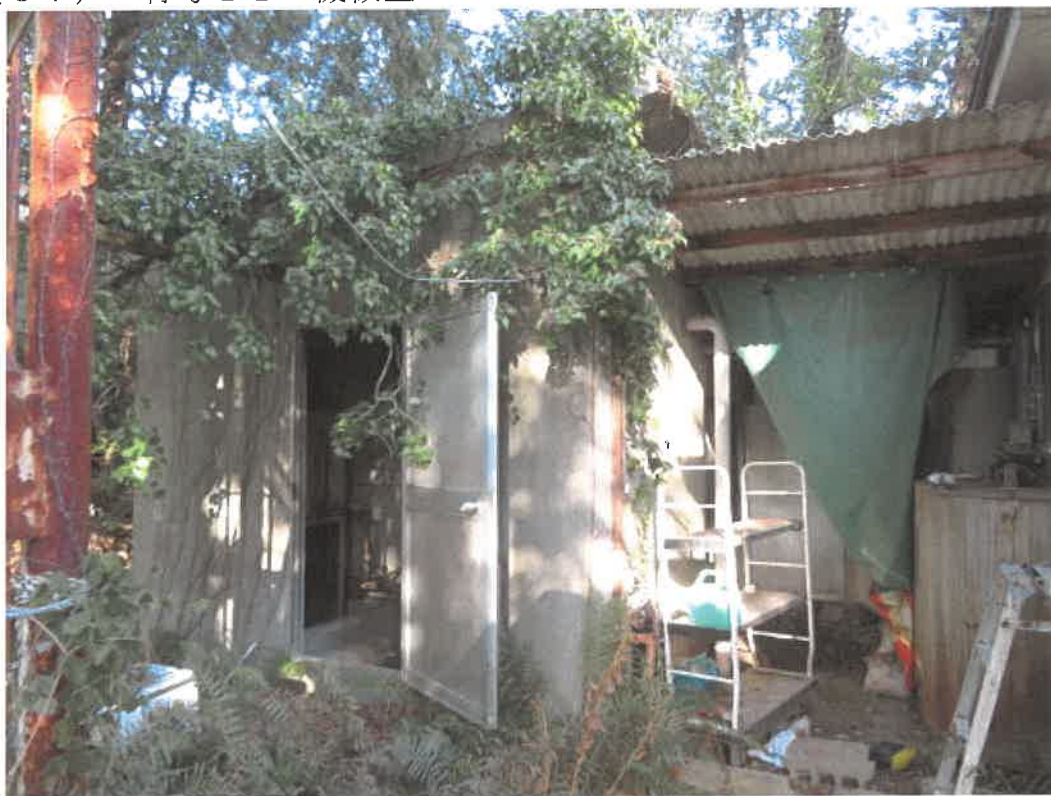
(写真 5 7) …符号 1 1・機械室
