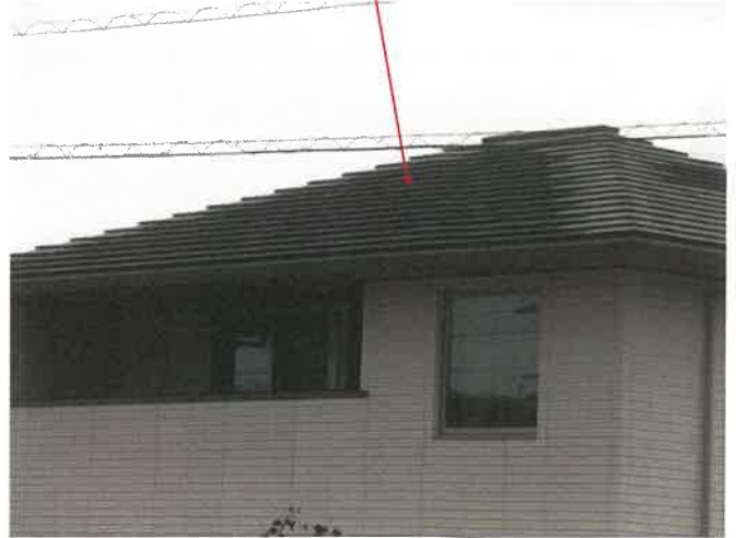
ソーラーパネルの固着状況
