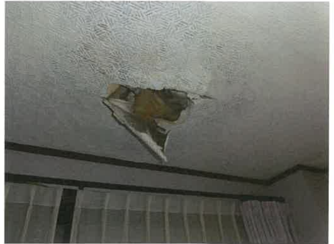
天井の損傷状況(洋室 2)
