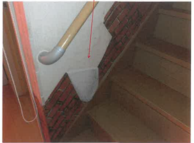
壁面の毀損状況
