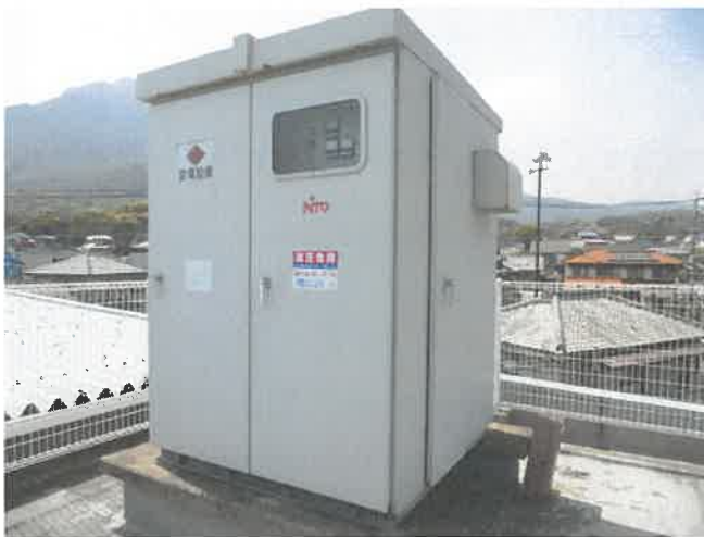
変電設備(屋上)
