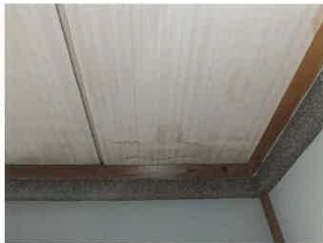
雨漏り痕の状況(和室天井)
