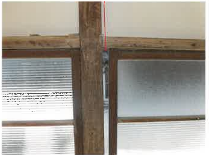
建付けの不具合箇所(縁側)
