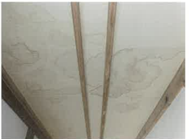
雨漏り痕の状況(縁側天井)
