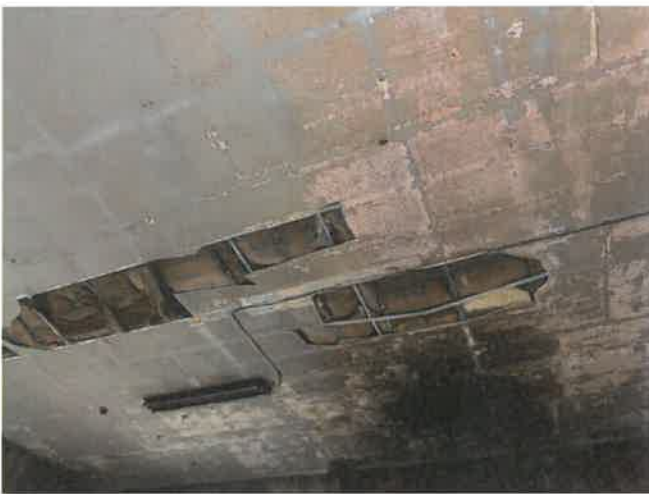
天井の損傷状況(作業場)
