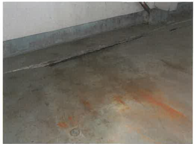
床の損傷状況(工場)
