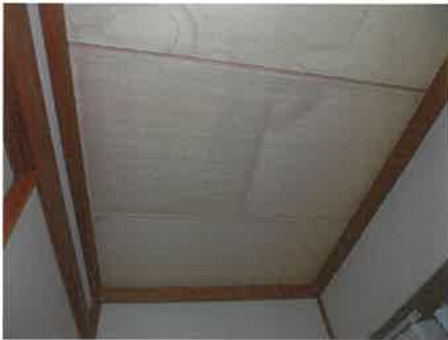
雨漏り痕の状況(縁側天井)
