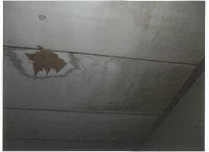
雨漏り痕の状況(和室天井)
