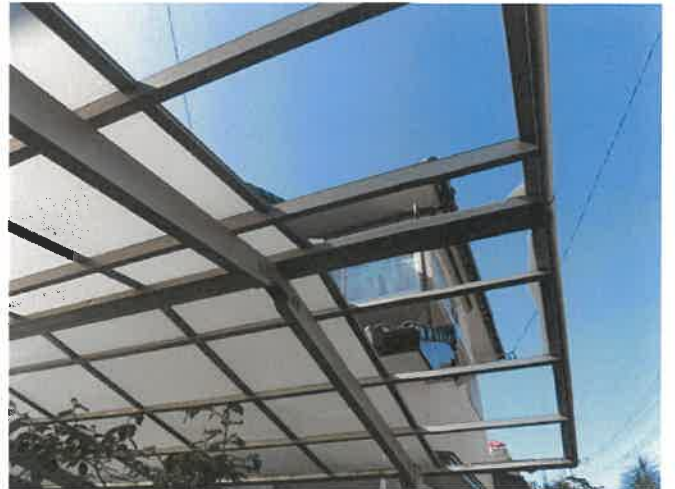
カーポート屋根の損傷状況
