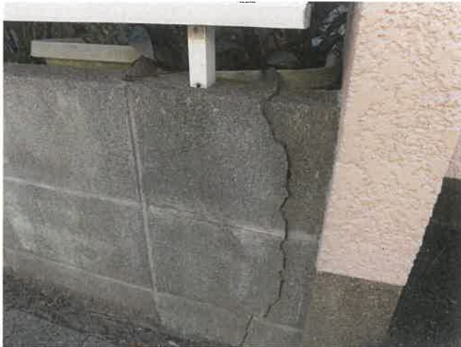
ブロック塀の損傷状況(玄関左側)
