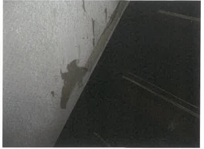
壁面の損傷状況(ペットのよるもの)
