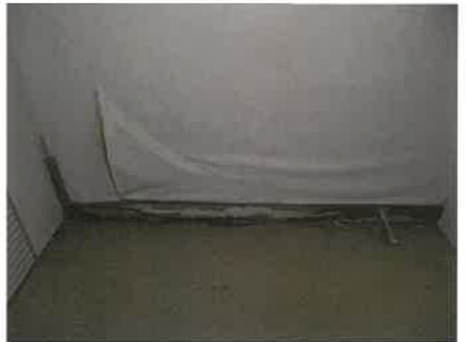
玄関壁面の剥離状況
