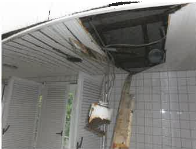
客室天井の崩落状況
