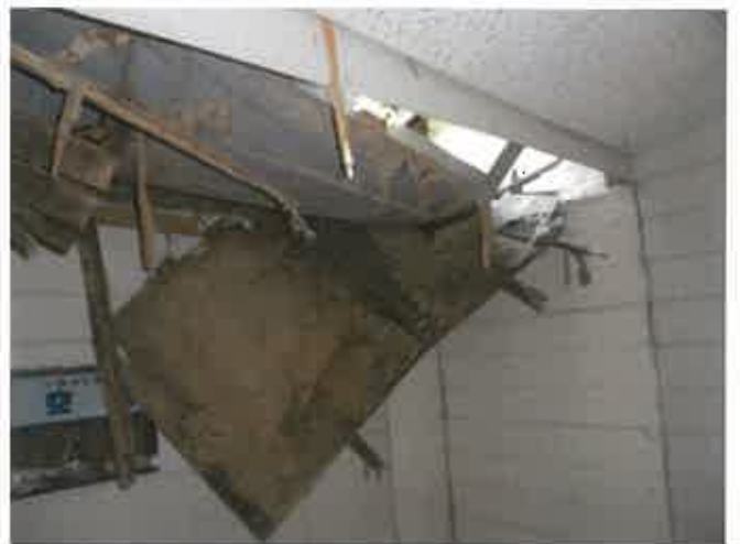
車庫天井の崩落状況
