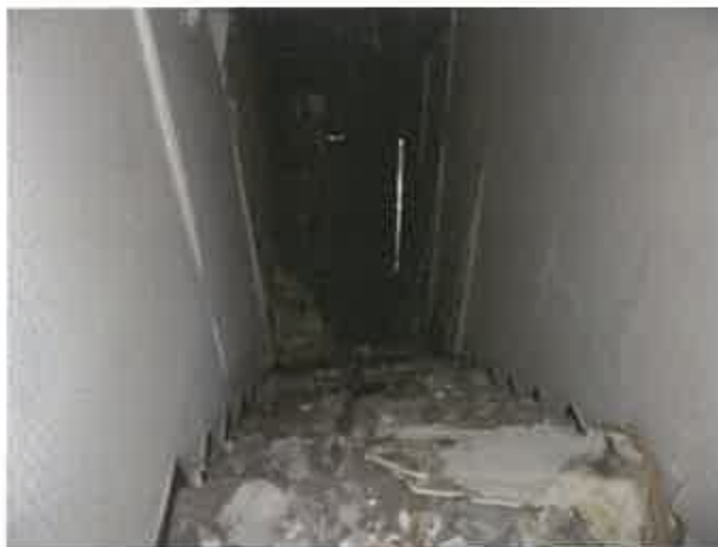
階段天井の崩落状況
