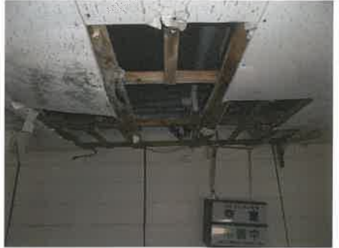
車庫天井の崩落状況
