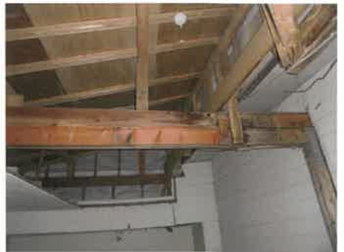
車庫天井の崩落状況
