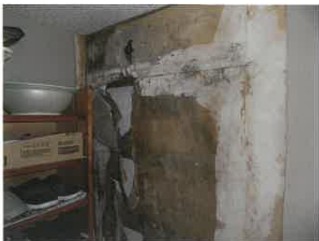
壁面の朽廃状況(リネン室)
