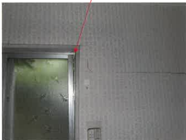
窓枠が傾いている状況(旧厨房)
