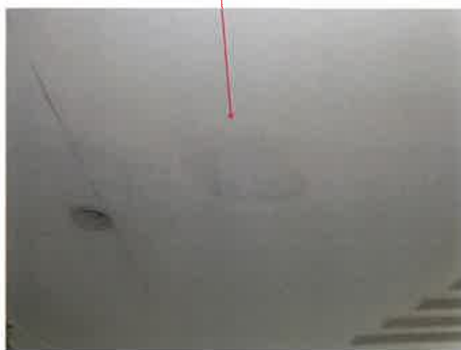
更衣室天井の雨漏り痕
