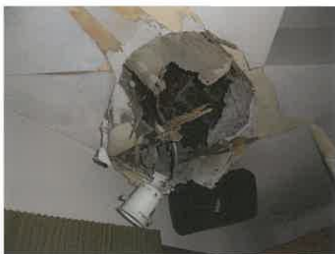
客室天井の崩落状況
