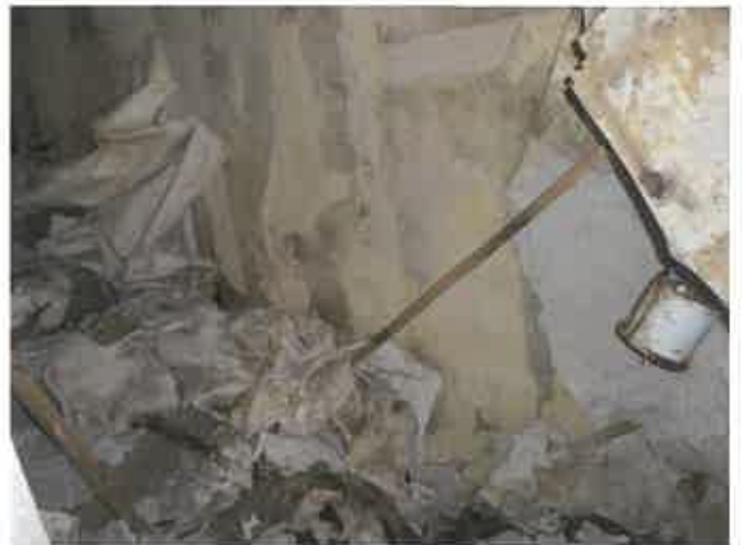
階段壁面の崩落状況
