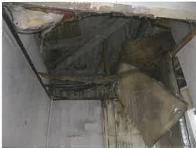
天井の崩落状況
