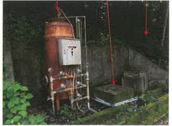
浄化装置制御盤 浄化槽 物件 6
