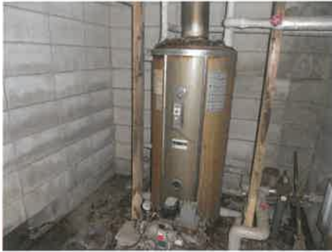
ボイラー室内部
