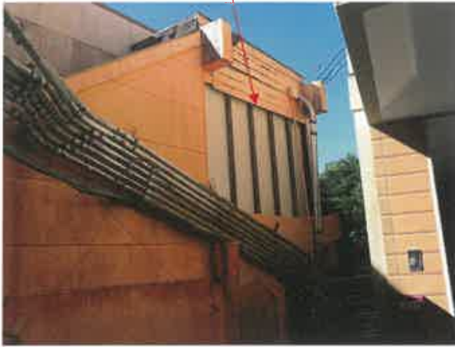
物件 19 建物壁面の崩落状況
