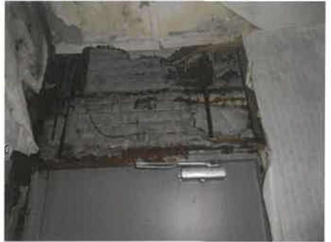
玄関壁面の崩落状況
