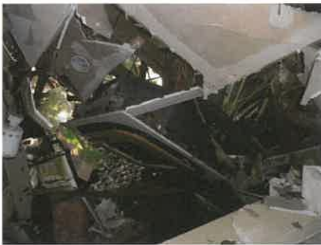
客室 (崩落状況)
