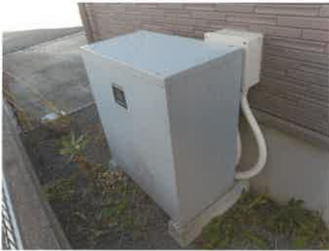
蓄電池の固着状況
