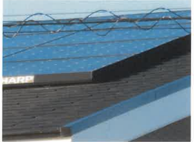
ソーラーパネルの固着状況
