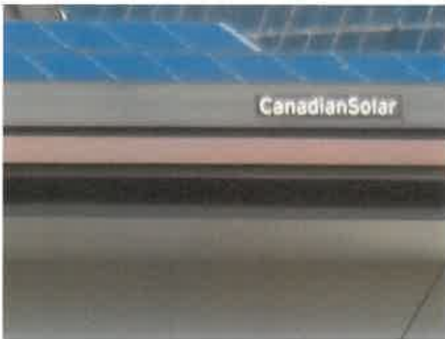
ソーラーパネルの固着状況
