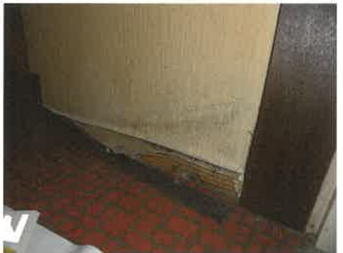
壁面の損傷状況(玄関)
