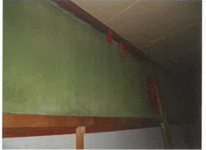
壁面の損傷状況(和室1)
