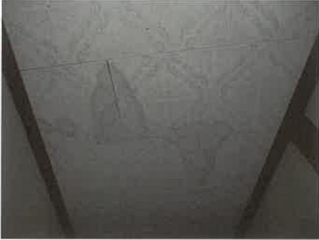
雨漏り痕の状況(トイレ南側の天井)
