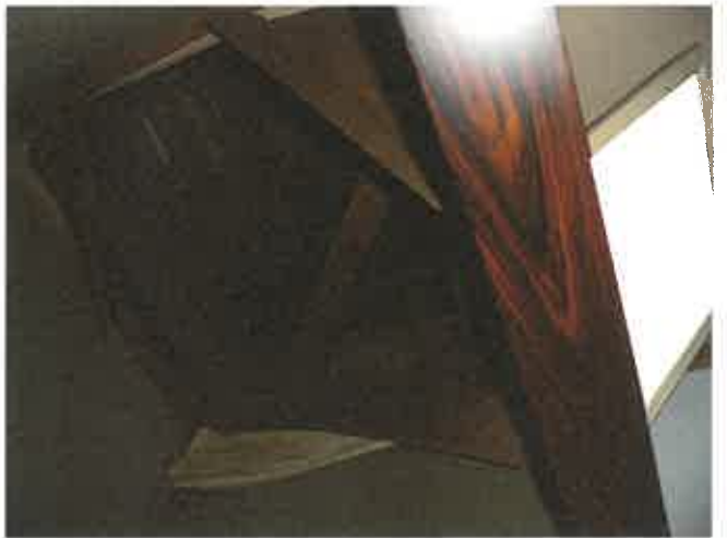
天井の損傷状況(床の間)
