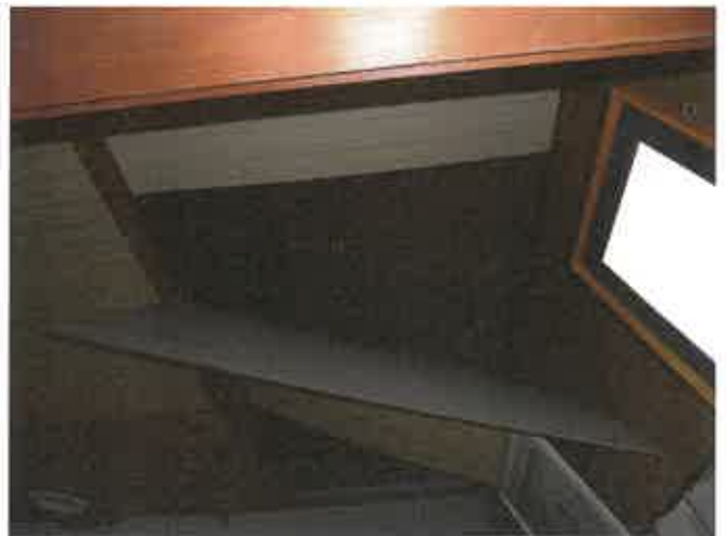
天井の損傷状況(洋室)
