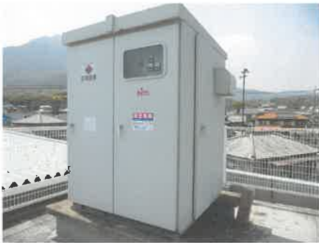
変電設備(屋上)
