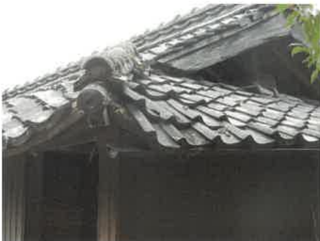
屋根の損傷状況
