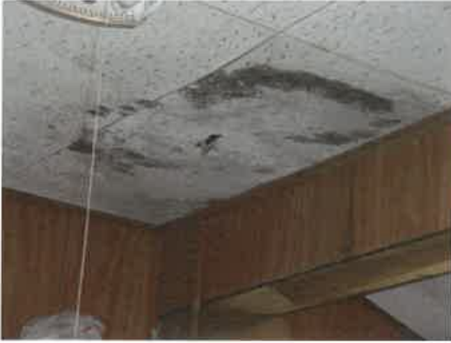
雨漏り痕状況(台所の天井)
