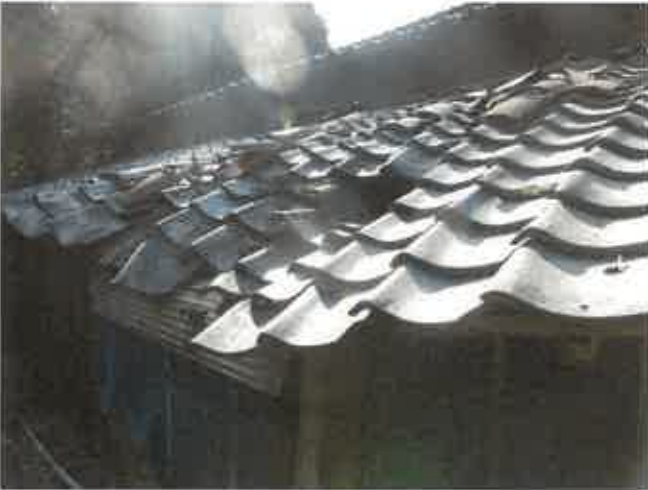
屋根部分の損傷状況(台所)
