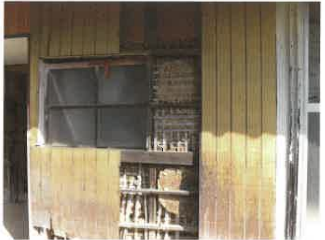
外壁の損傷状況(玄関右横)
