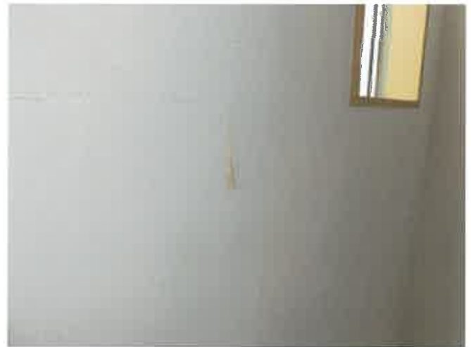
壁紙の剥離(2 階ホール)
