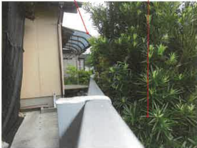
サニターフの越境状況 隣地 2799-1
