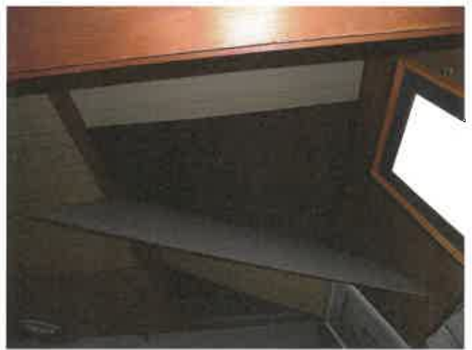
天井の損傷状況(洋室)
