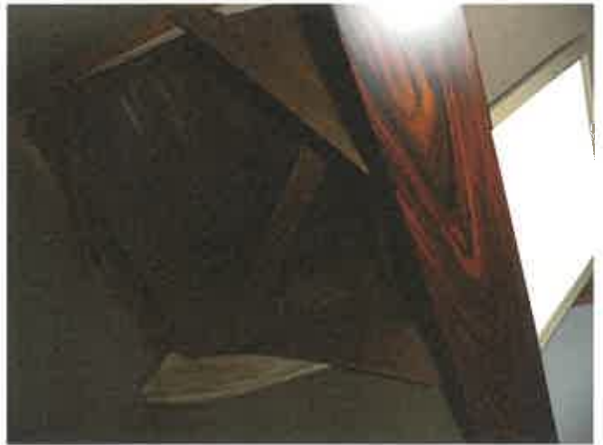
天井の損傷状況(床の間)
